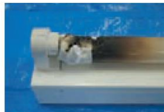
直管LEDランプの焼損例
