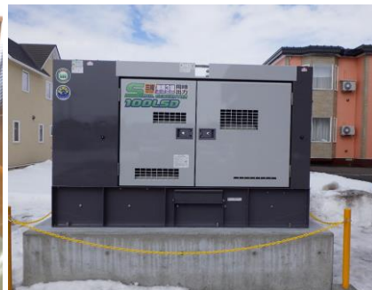
↑ 設置した発電機
